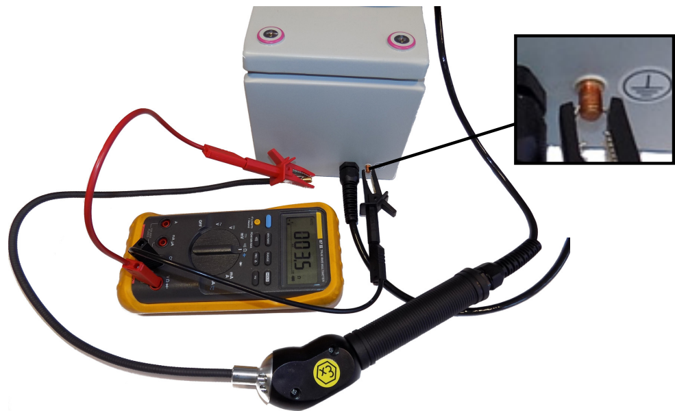
Fig. 3: Contrôle de la liaison entre filtre capillaire et terre
